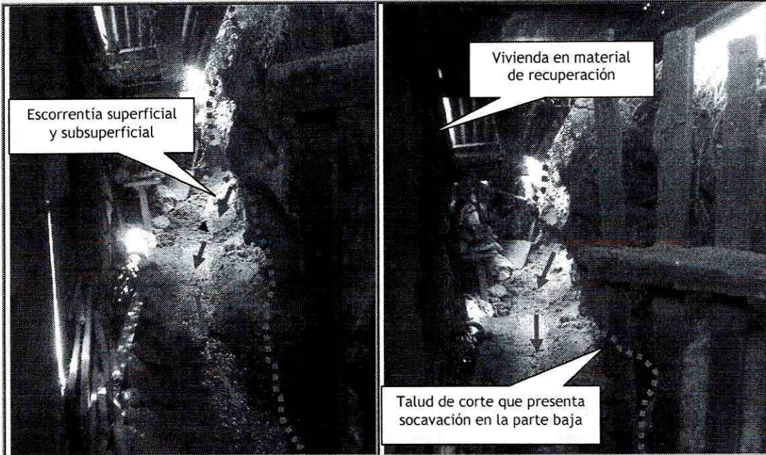
Foto No. 3 y 4. Socavación y arrastre de material del talud de corte con pendiente de tendencia vertical ( \beta=90^\circ ), evidenciado por la presencia de escorrentía superficial y subsuperficial en la parte baja del mismo
