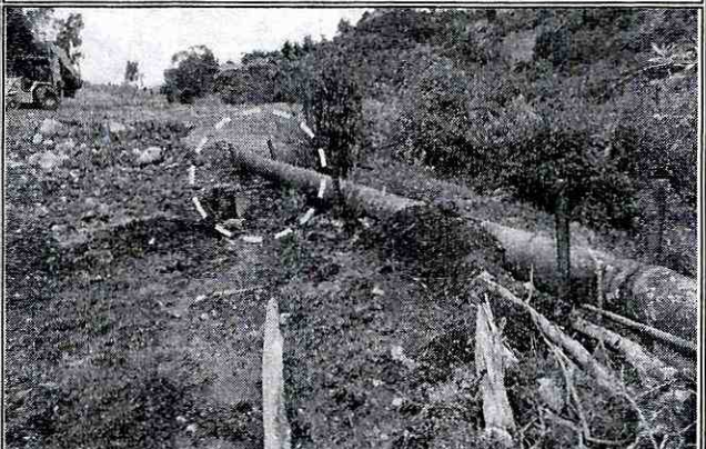
Foto 7. Se aprecia la línea de aducción, con deformaciones y afectación de los soportes "H" que sirven de apoyo a una de las tuberías.
