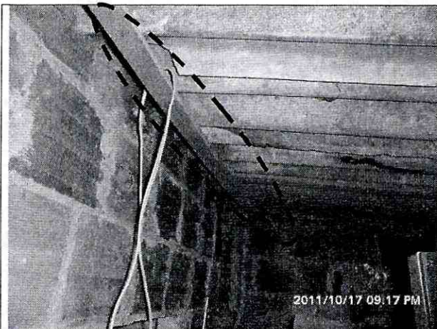
Foto 3. Se observa la indebida instalación, el alto grado de flexión y el deterioro de los elementos de madera que soportan la cubierta.
