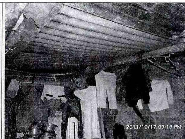
Foto 4. Se observa la indebida instalación, el alto grado de flexión y el deterioro de los elementos de madera que soportan la cubierta.
