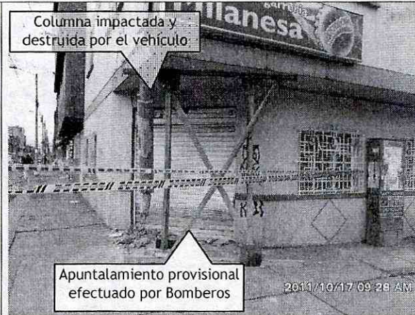
Foto 2. Afectaciones generadas en la fachada del costado oriental por causa del impacto del Vehículo, también se visualiza el apuntalamiento preventivo realizado por los Bomberos.
