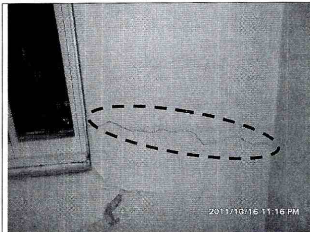
Foto 3. Fisuras de tendencia horizontal evidenciadas en el vértice oriental de la vivienda, en el segundo nivel.
