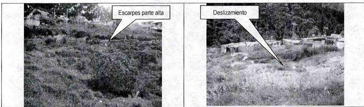
Foto 5. Se observan fenómenos de remoción en masa presentes hacia la parte alta del barrio Laureles a un distancia de 60 m aproximadamente, con escarpes que superan los 0.50 m.
