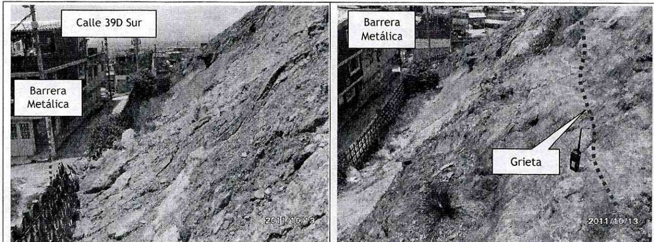
Fotos 11 y 12. Se aprecia que los niveles de arenisca del Sector 2 del antiguo frente de explotación minera, se encuentran altamente meteorizados y fracturados, presentándose movilización de pequeños bloques de arenisca y arena que han llegado a impactar la barrera metálica, provocado su pérdida de verticalidad a la altura del predio con nomenclatura Carrea 8A No. 39A-04 Sur, identificado como Lote 12 Mz 4, actualmente un lote vacío. Adicionalmente, se evidencia la presencia de grietas en las unidades de arenisca, con longitudes que pueden alcanzar hasta 10 m y abertura 1 cm, lo cual marca una posible cuña inestable que podría desprenderse en el corto plazo.
