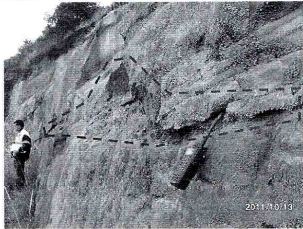
Foto 7. Vista de uno de los cortes del antiguo frente de explotación minera, donde se observan gruesas secuencias de areniscas con delgadas intercalaciones arcillosas, que son fácilmente erosionadas, generando cuñas de roca que son desprendidas desde los antiguos frentes de explotación minera.
