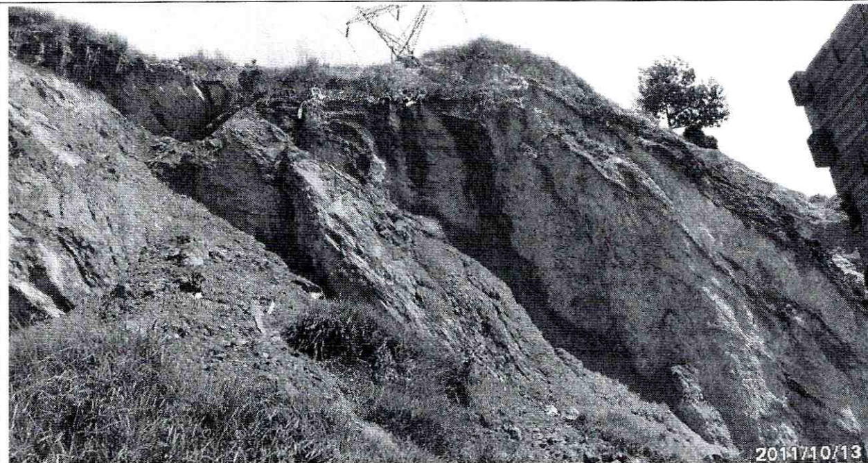
Foto 13. Vista del Sector 3 del antiguo frente de explotación minera, donde se aprecia un proceso de remoción en masa de carácter local, correspondiente a desprendimientos de material arcilloso y arenoso.
