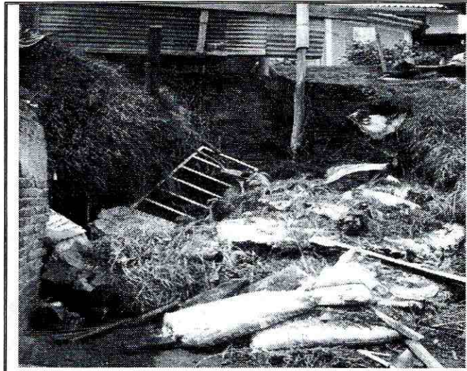
Fotografía 3. Se observa el desprendimiento del talud de corte el cual se depositó en la parte baja de la vivienda Calle 82 A Sur No. 18 N - 28.
