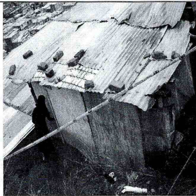
Fotografía 2. Se observa la vivienda de la Calle 78 C Sur No. 14-26 afectada por el impacto del muro de cerramiento.
