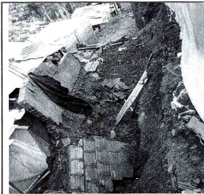
Fotografía 1. Se observa el colapso del muro de cerramiento y el impacto hacia la vivienda de la Calle 78 C Sur No. 14-26.
