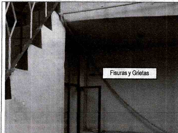
Foto 7. Vista de muro interno del predio de la Carrera 69 A No. 78-28. Tomada el 16 de Mayo de 2011 (DI-5649). Donde se evidencia fisura de 1 a 2 cm de espesor aproximadamente.
