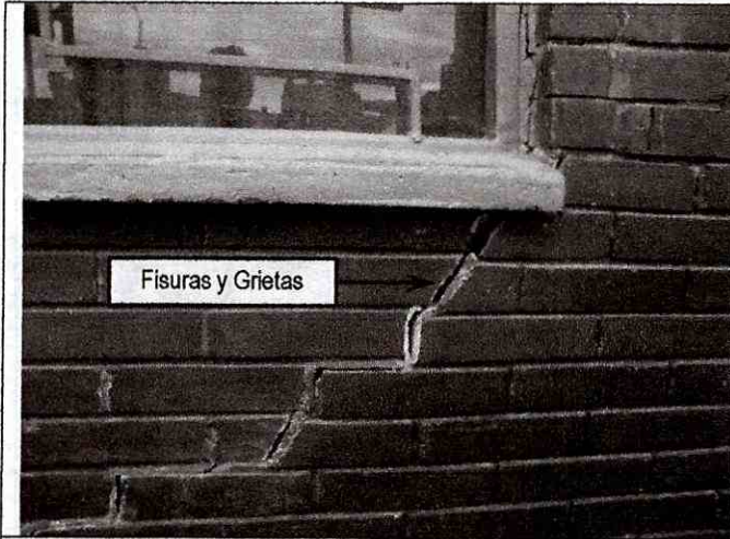
Foto 3. Vista de muro de la fachada del predio de la Carrera 69 A No. 78-40. Tomada el 16 de Mayo de 2011 (DI-5649). Donde se evidencia fisura de 2 cm de espesor aproximadamente.
