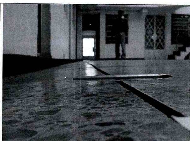
Fotografía No. 3. Se Observa la inclinación de la placa de contrapiso en el costado occidental de la vivienda emplazada en la Calle 161 No. 21 - 55 en el Barrio Orquídeas de la Localidad de Usaquén.
