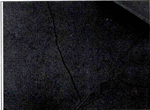
Fotografía No. 4. Se Observa las grietas sobre la placa de contrapiso en el costado occidental de la vivienda emplazada en la Calle 161 No. 21 - 55 en el Barrio Orquídeas de la Localidad de Usaquén.
