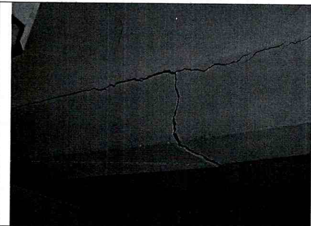
Fotografía No. 2. Se Observa las afectaciones sobre elementos estructurales que comprometen la funcionalidad y de costado Occidental de la vivienda emplazada en la Calle 161 No. 21 - 55 en el Barrio Orquídeas de la Localidad de Usaquén.
