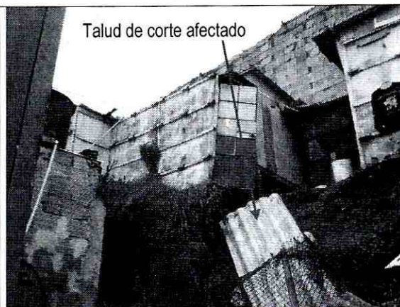
Foto 2. Talud de corte afectado en la parte posterior de los predios evaluados, se presenta colapso de elementos de la vivienda.
