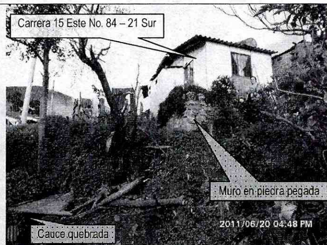
Foto 2. La vivienda de la Carrera 15 Este No. 84 – 21 Sur, se encuentra emplazada sobre un relleno confinado con un muro de piedra pegada el cual presenta agrietamientos posiblemente causados por deficiencias constructivas.
