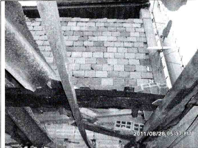
Foto 5. Afectación de la cubierta de la cubierta de la parte posterior de la vivienda de la Carrera 59 C Bis No. 132 A - 37.
