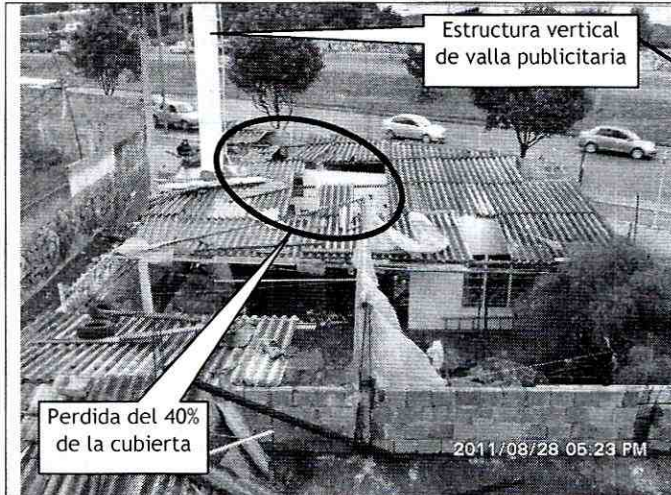
Foto 7. Se observan las afectaciones en la vivienda de la Carrera 59 D No.131 - 25 Int. 3 y 4, en donde se encuentra emplazada una valla publicitaria de OPE.
