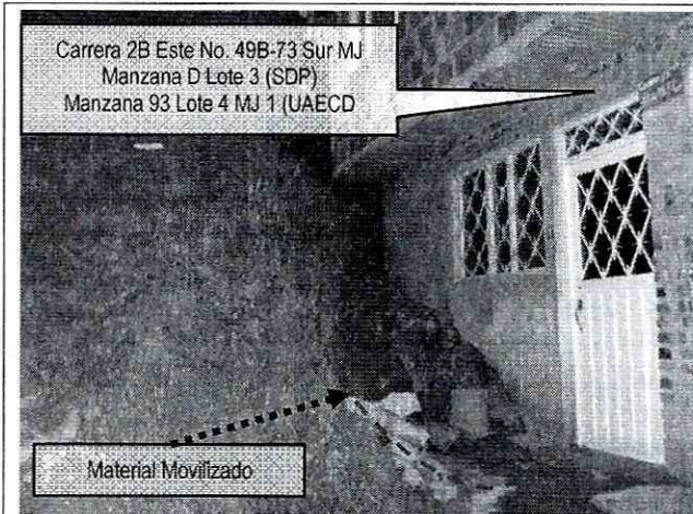
Fotos 2 .Vista del material desprendido del talud de corte el cual se depositó en el área de andén, impactando el muro de fachada de la vivienda emplazada en el predio de la Carrera 2B Este No. 49B-73 Sur Manzana D - Lote 3, sin presentar afectaciones en la estructura de la vivienda.
