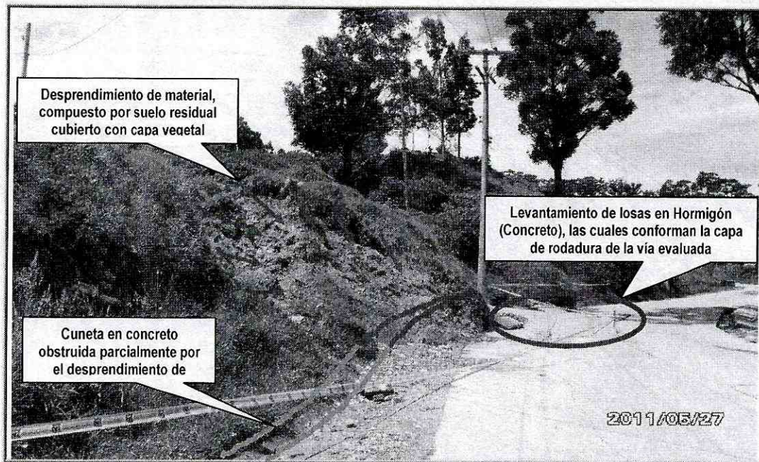
Fotografía No. 3. Vista general del primer talud de corte que presentó desprendimiento de material, localizado al costado oriental de la Avenida Carrera 13 A Este entre la Calle 28 B Sur y la Calle 29 Sur del Barrio Amapolas de la Localidad de San Cristóbal.
