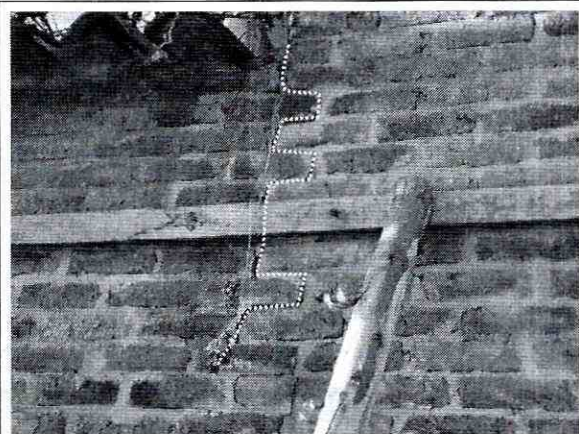
Fotografía 3. Agrietamiento y empuje horizontal identificado en el muro de cerramiento del costado sur del predio ubicado en la Cl. 147 B No. 89 - 76, barrio Suba Urbano.
