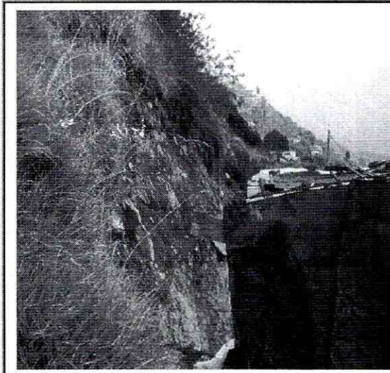
Fotografía 2. Vista del talud de corte sector norte carente de medidas de protección y/o estabilización, así como también de sistemas para el manejo del drenaje
