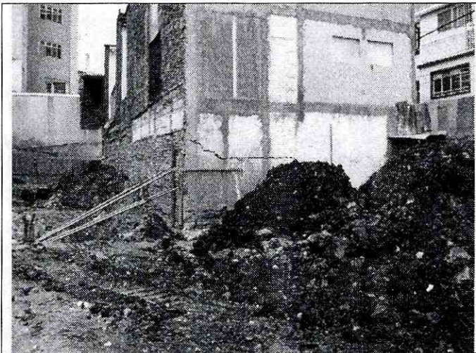
Foto 1. Predio CI 63 A Bis 14-46 en parte posterior donde se encuentra apuntalado provisionalmente.
