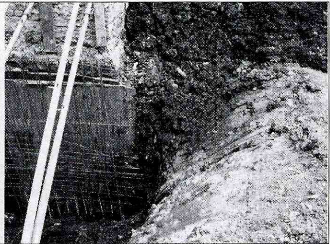
Foto 2. Detalle de la pantalla de contención pre-excavada en parte posterior del predio CI 63 A Bis 14-46
