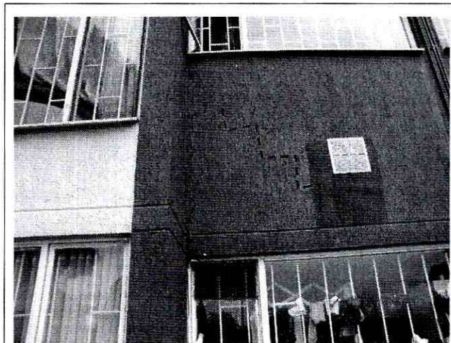
Foto 3. algunas fisuras evidenciadas sobre las fachadas de las torres que conforman Conjunto Residencial Santa Helena 8
