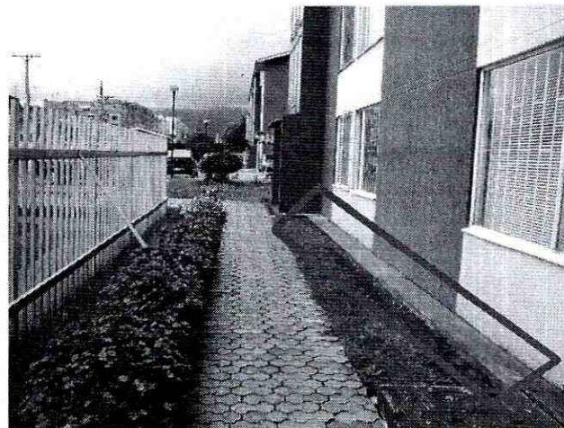
Foto 2. Leves asentamientos diferenciales del edificio
