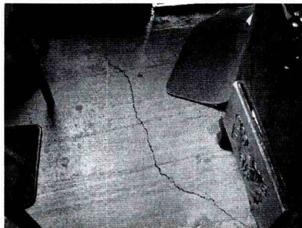
Foto 25. Se observa el agrietamiento de la placa de contrapiso debido a asentamiento diferenciales de la vivienda ubicada en la Carrera 17 N Bis No. 79-37 Sur (Fotografía tomada el 27-10-11).
