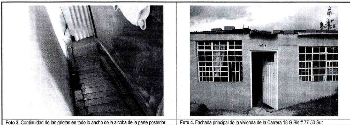
Foto 3. Continuidad de las grietas en todo lo ancho de la alcoba de la parte posterior.
