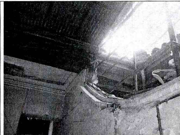
Foto 3. Afectaciones en la unidad del costado oriental.
