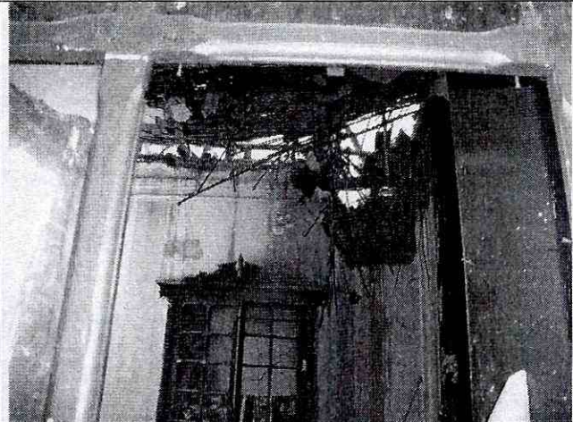
Foto 2. Zona de colapso parcial de cubierta.
