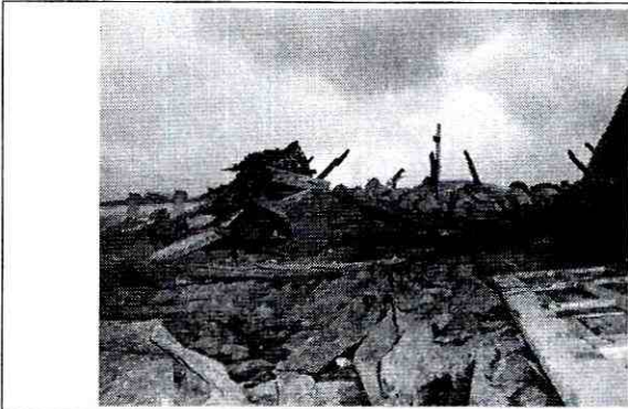
Fotos 9 Se observa estado de la cubierta después del incendio
