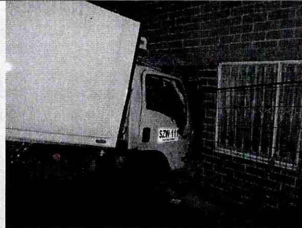
Foto 2. Afectaciones generadas en la fachada del costado oriental por causa del impacto del camión.
