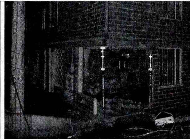
Foto 3. Labores de apuntalamiento preventivo de la placa de entrepiso del segundo nivel, realizadas durante el retiro del vehículo accidentado.
