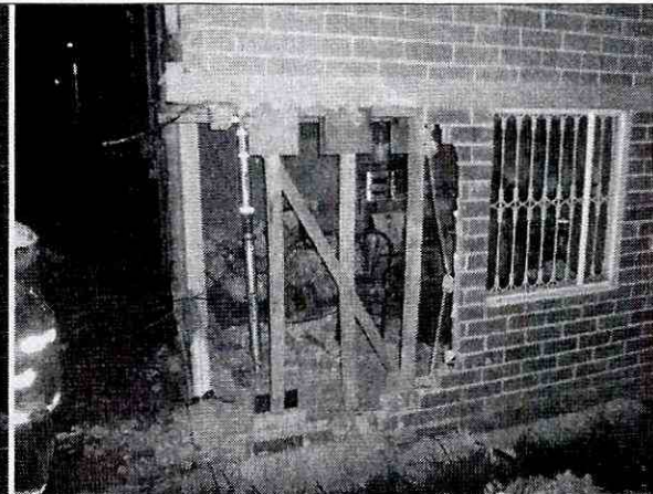
Foto 4. Estado de la edificación residencial al final de las operaciones de atención de la emergencia.
