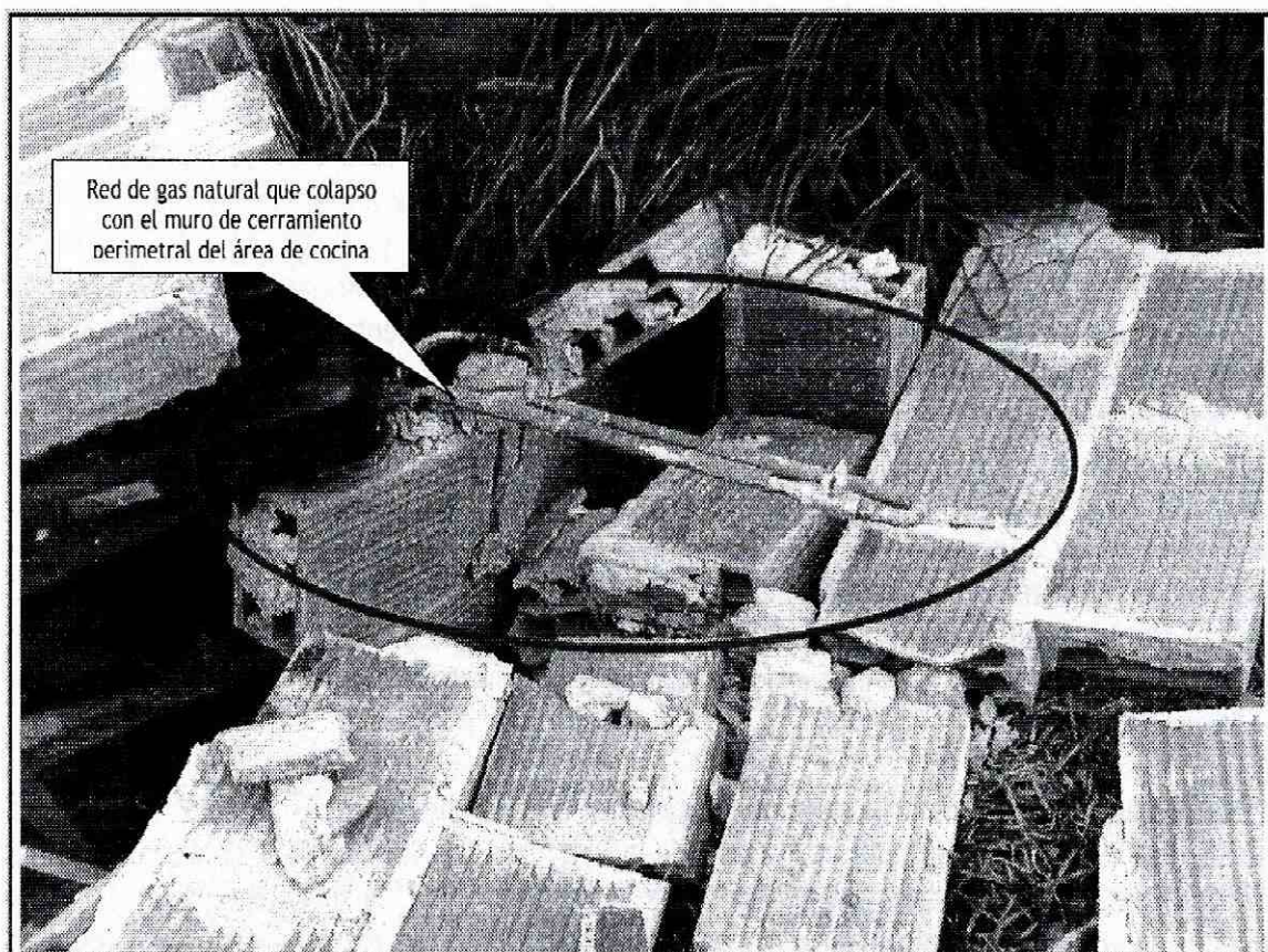
Foto No. 2. Vista general del muro de cerramiento perimetral colapsado al interior del predio de la Calle 82 C Bis Sur No. 44 B 28, en donde se evidencia riesgo inminente en las redes de gas natural y acueducto.
