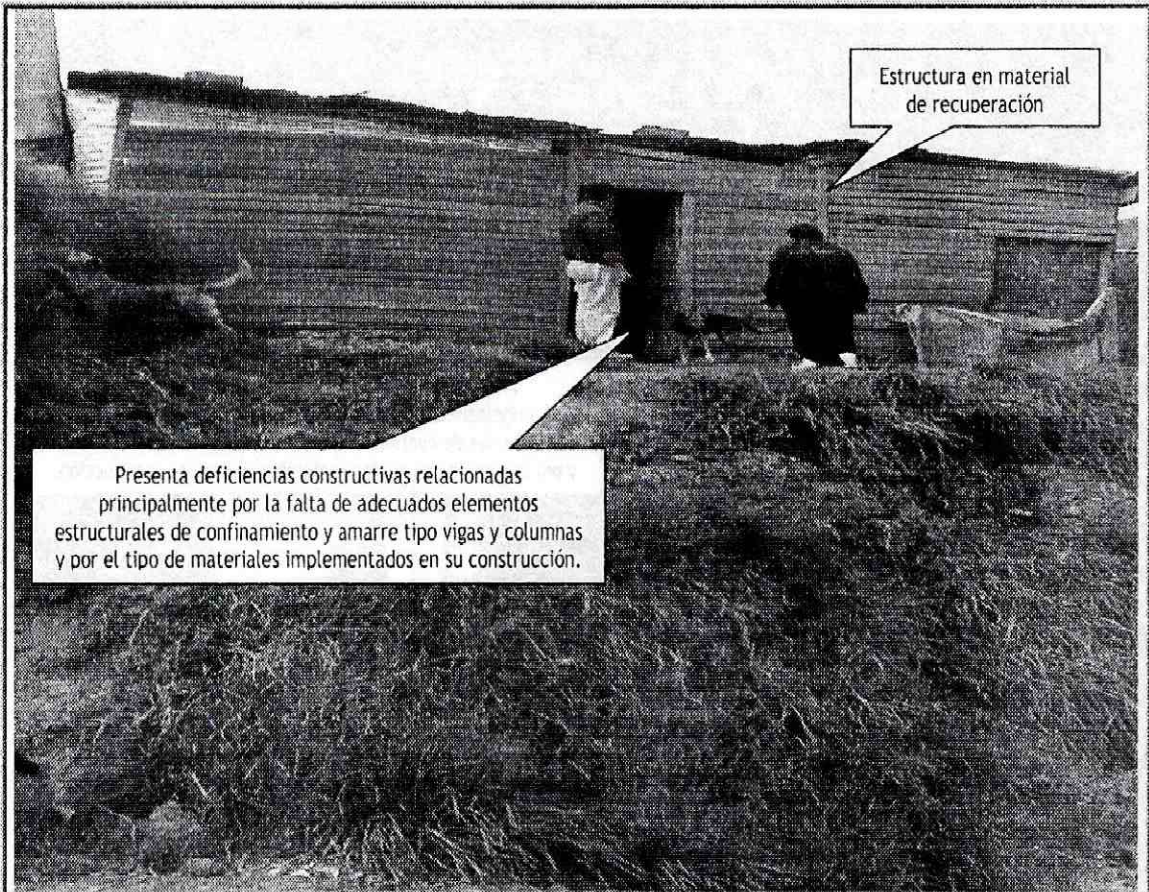
Foto No. 3. Vista general del predio localizado en la Calle 82 C Bis Sur No. 44 B 34 del Barrio Jerusalén Sector Potosí de la Localidad de Ciudad Bolívar, en Atención al Evento de Emergencia 114829 del 5 de Junio de 2011.
