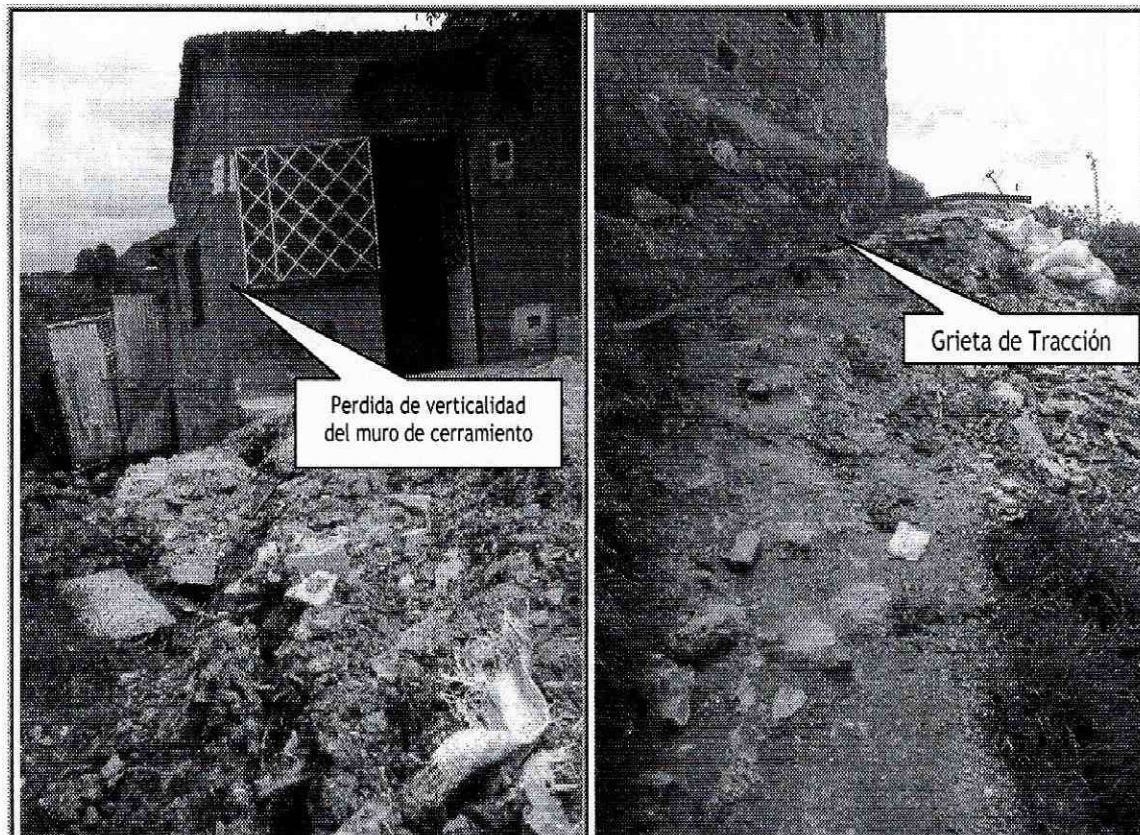
Foto No. 2. Vista al exterior de la vivienda, donde se evidencia la pérdida de verticalidad del muro de cerramiento perimetral.
