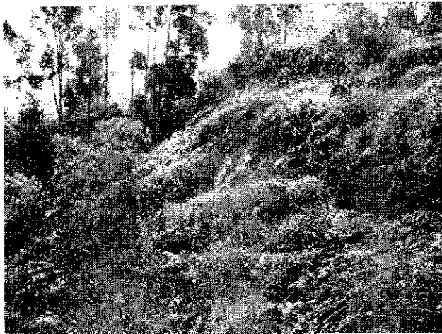
Foto 4. Procesos erosivos sobre el talud por escorrentías de carácter superficial y subsuperficial.
