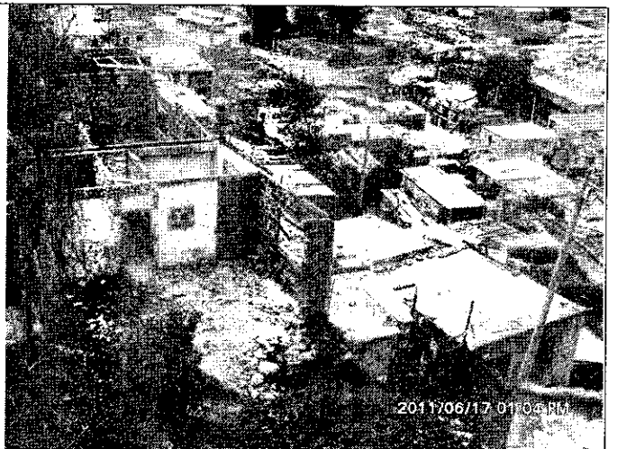
Foto 4. Los muros de la edificación en ruinas presentan alto riesgo de caída y algunas de sus paredes pueden impactar la vivienda vecina ubicada en la parte baja.
