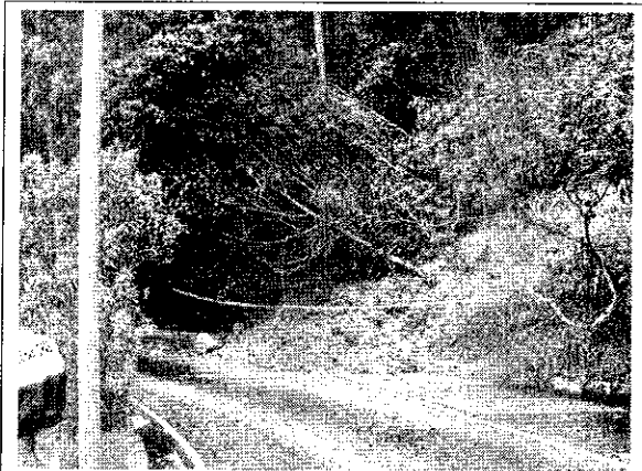
Foto 1. Material movilizizado compromete la transitabilidad del tramo de vía evaluado.
