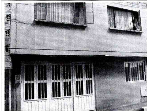
Foto 1. Vista de la fachada de la vivienda evaluada en la Transversal 17C No. 36A - 18 Sur, donde no se evidencian afectaciones por el proceso de remoción en masa.
