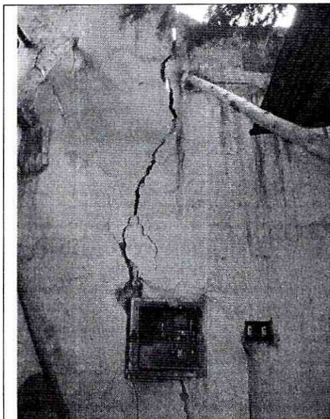
Foto 3. Grietas severas en el muro del costado noroccidental de la construcción visitada.
