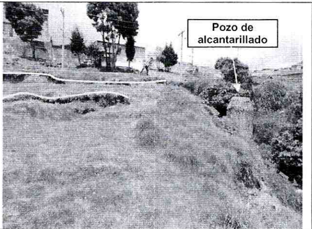
Foto 7. Continuidad del escarpe, y Alcantarilla y curso de aguas negras que se encauza en el sector debido a la ruptura y desplazamiento de la red de alcantarillado en la parte norte del parque de Santa Rita Suroriental.
