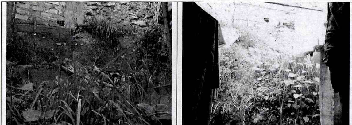
Foto 1 y 2. Vista al costado sur (posterior) de la vivienda emplazada en el predio de la Calle 32 Bis Sur # 15-. Se observa el talud de corte desprovisto de medidas de contención y de drenaje. (Septiembre 9 de 2011)
