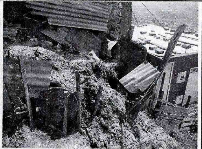
Foto 3. Procesos de inestabilidad del terreno de carácter local evidenciados sobre la parte media de la ladera.
