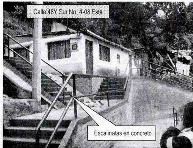
Foto 6. Vista panorámica de la vivienda emplazada en el predio de la Calle 48Y Bis Sur No. 4-08 Este, del Barrio Diana Turbay de la Localidad de Rafael Uribe, donde se observan escalinatas de concreto que dan acceso a la vivienda las cuales se encuentran en condiciones estables al servicio. Adicionalmente se evidencia que el predio en mención se encuentra localizado en la parte baja de una ladera.
