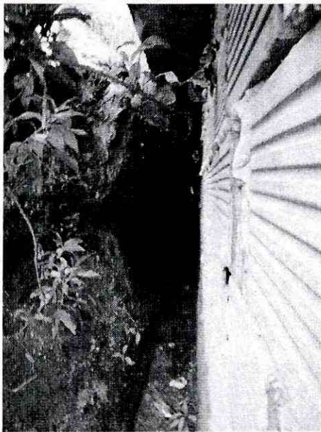
Fotos 8. Vista del talud de corte de tendencia vertical, realizado posiblemente para el emplazamiento de la vivienda del predio de la Calle 48Y Sur No. 4-08 Este, donde se evidencia que no cuenta con obras de estabilización ni sistemas para el drenaje de las aguas de escorrentía superficial ni sub-superficial. Adicionalmente se evidencia que el muro perimetral de la vivienda se encuentra muy próximo al talud de corte en concreto.
