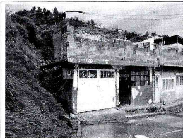
Foto 2. Vista de la vivienda emplazada en el predio de la Carrera 5 Este No. 48Y-06 Sur, en donde se evidencia que la edificación se encuentra muy próxima a la ladera que tiene una pendiente aproximada a 50°, la cual se encuentra localizada hacia el costado Nor-Oriental de la vivienda en mención.
