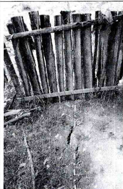
Foto 5. Grieta de tracción en acceso a la vivienda del Lt 15 de la Mz 21.
