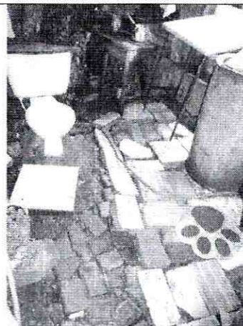
Foto 7. Rellenos en área de baño del Lt 3 de la Mz 21
