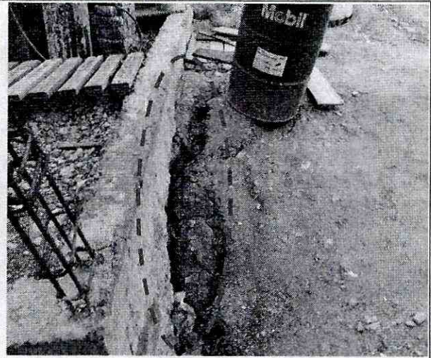
Fotografía 4 Detalle de la afectación de la cimentación donde se emplaza la vivienda construida con material de recuperación en la Calle 48 J Sur No. 12 - 56
