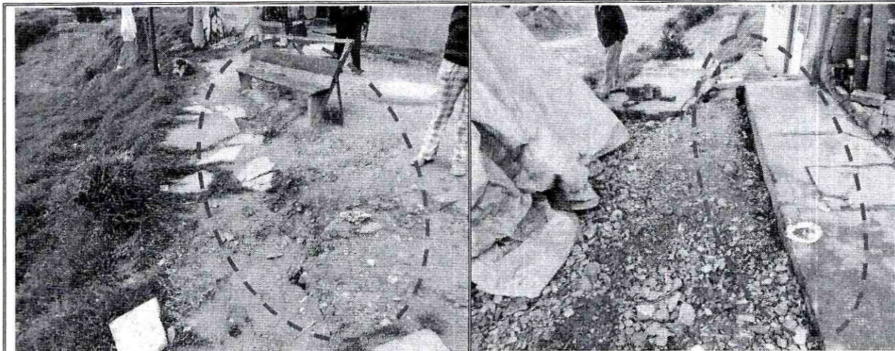
Fotografía 7 Afectación de los predios por el proceso de remoción en masa observado.
