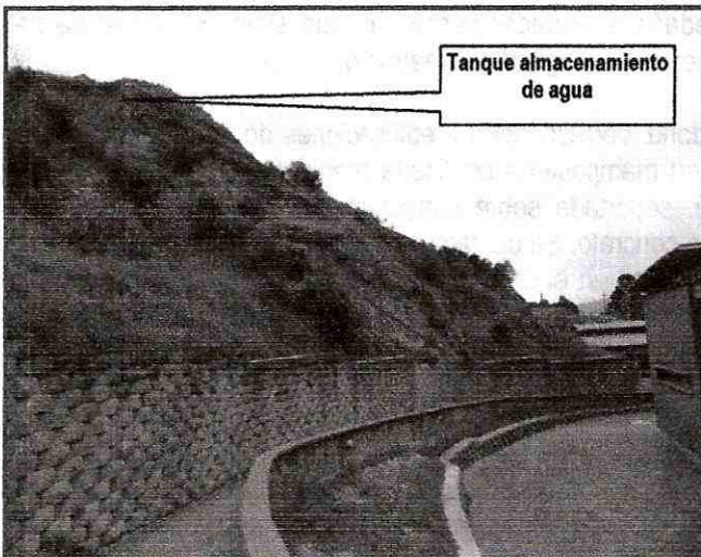
Foto 2. Vista del proceso de inestabilidad que afecta al talud de corte, y sus características geométricas.
