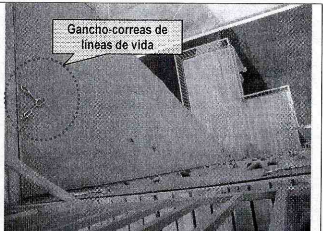
Foto 8. Vista detalle de elementos de anclaje de las líneas de vida, aparentemente no cuentan con la suficiente rigidez para soportar las cargas normales de servicio.
