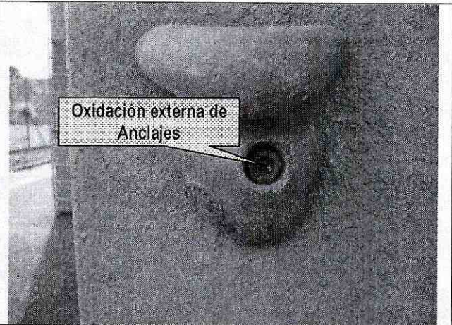
Foto 6. Vista externa y detalle de elementos de apoyo de los escaladores, se identifica presencia de oxidación en elementos de anclaje de los elementos de apoyo de los escaladores.
