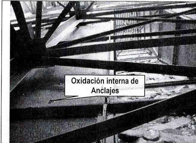
Foto 5. Vista interna de la estructura del muro, tomada desde abajo hacia arriba, se identifican presencia de oxidación en elementos de anclaje de los elementos de apoyo de los escaladores.
