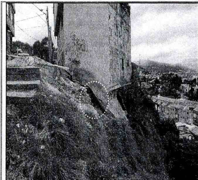
Foto 5. Vista de la parte alta de la ladera donde se ubicaba el fragmento rocoso a la altura de la Carrera 4 con Calle 180C, en el barrio el Codito de la localidad de Usaquén, al parecer retirado de manera controlada por personal de obras de la alcaldía local. (Julio 05 de 2012).
