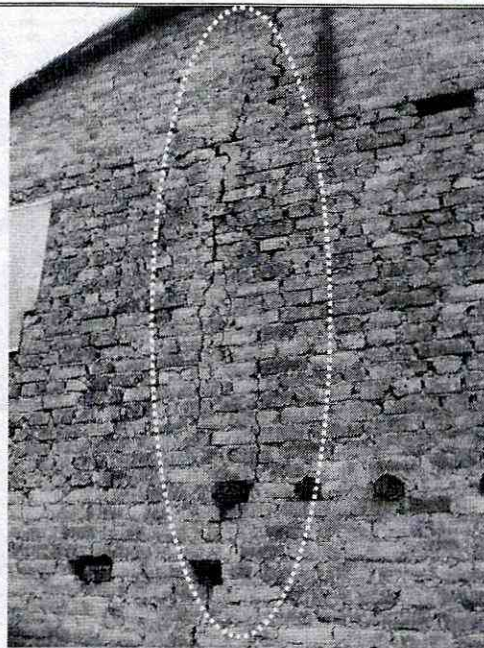
Foto 6. Agrietamientos en mampostería de la vivienda de la Finca los León, obsérvese que se presentan de piso a techo
