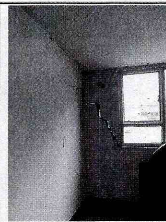
Foto 3. Se observan grietas y fisuras en algunos muros construidos al interior del predio evaluado.
