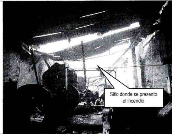
Foto 2. Vista general de la zona posterior del predio de la Carrera 116 No. 17-20, en la zona de bodega donde se presentó el incendio. Se observa el colapso parcial de la cubierta.
