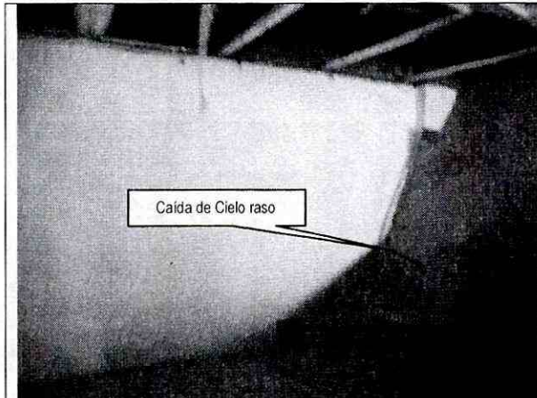
Foto 5. Vista de una de las oficinas del segundo nivel de la edificación emplazada en el predio de la Carrera 116 No. 17-90, donde se observa el desprendimiento parcial del cielo raso.
