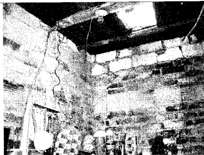
Foto 4. Vista interna de la vivienda, detalles de las deficiencias constructivas, como combinación de tipos de mampostería y carencia de elementos de confinamiento.
