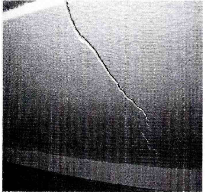
Foto 6. Afectaciones reflejadas sobre los cielo-rasos en drywall, acrílico e icopor que hacen parte de la construcción evaluada.
