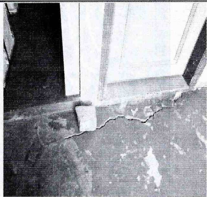
Foto 2. Detalle de la fractura en la placa de contrapiso
