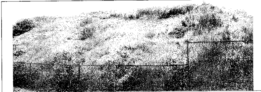
Foto 1. Vista desde la parte baja (pata) de uno de los fenómenos de remoción en masa presentes en el talud de corte localizado al costado occidental del predio evaluado en la zona colindante con las viviendas 255 a 222.
