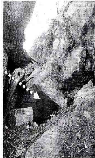
Foto 3. Vista del costado oriental del predio, donde se observa el material desprendido del talud de corte.
