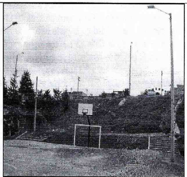
Foto 2. Vista de la parte media de la ladera entre las terrazas 1 y 2 donde se evidencia que el material que se encontraba en la parte alta fue arrastrado por las fuertes lluvias hasta la cancha.
