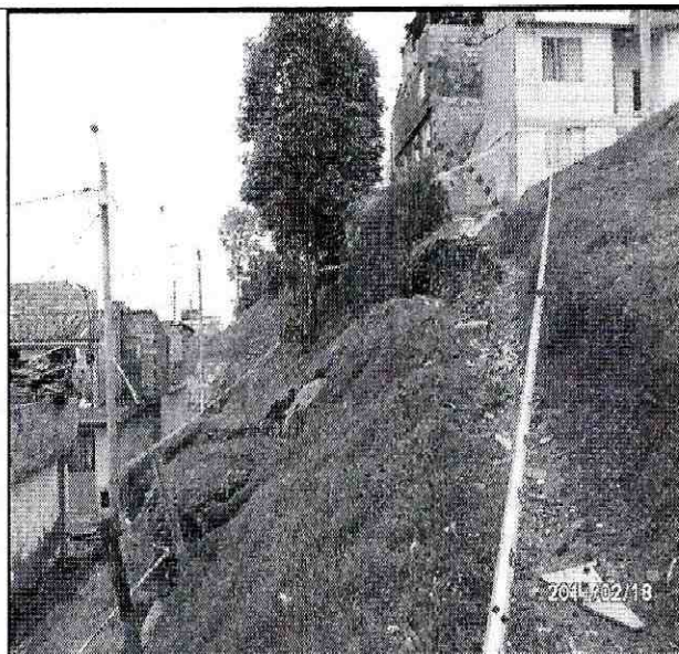
Foto 4. Detalle del proceso de remoción en masa presentado frente a las viviendas de la Urbanización Granada Sur, lo que produjo el colapso parcial del sendero peatonal.
