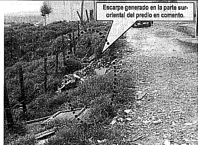
Foto 2. Escarpe de longitud aproximada de 12m generado por el deslizamiento en el barrio la Carbonera II.
